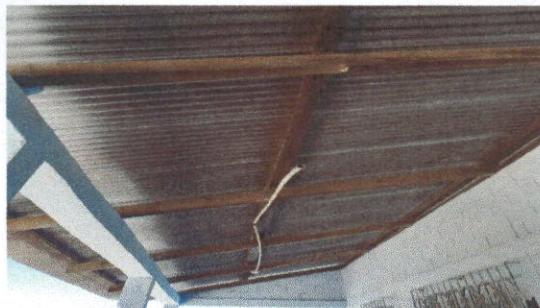
Foto 1: Sistema eléctrico en mal estado, cables en mal estado, plafoneras, apagadores, cajas rectangulares.
