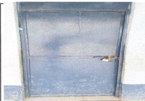
Foto 4: Chapas de puertas en mal estado, necesrio cambiarlo
