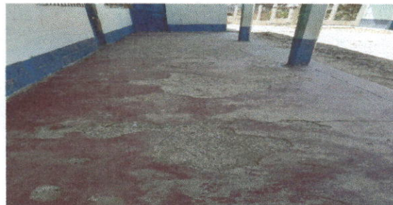
Foto 2: torta de concreto en mal estado, se quiere mejorar colocandole piso cerámico.
