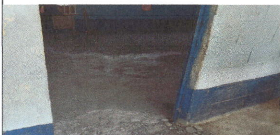
Foto 5: Muros en mal estado, necesario mejorar con pintura.
